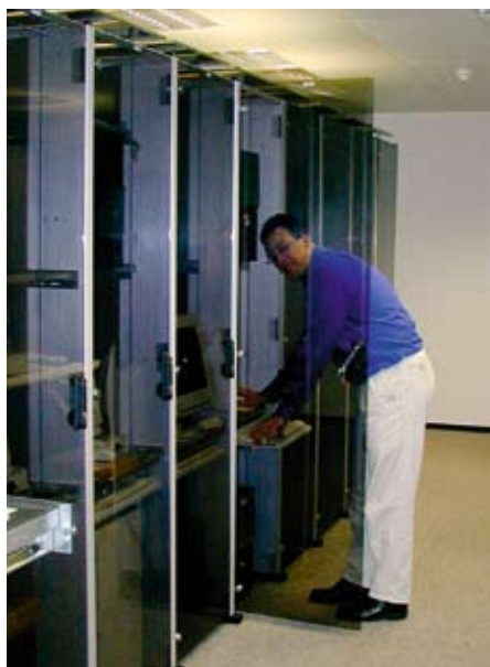
Das Rechenzentrum der nordIT zeichnet sich u.a. durch hohe Verfügbarkeit, doppelte Absicherung und zentrale Dokumentation aus.
